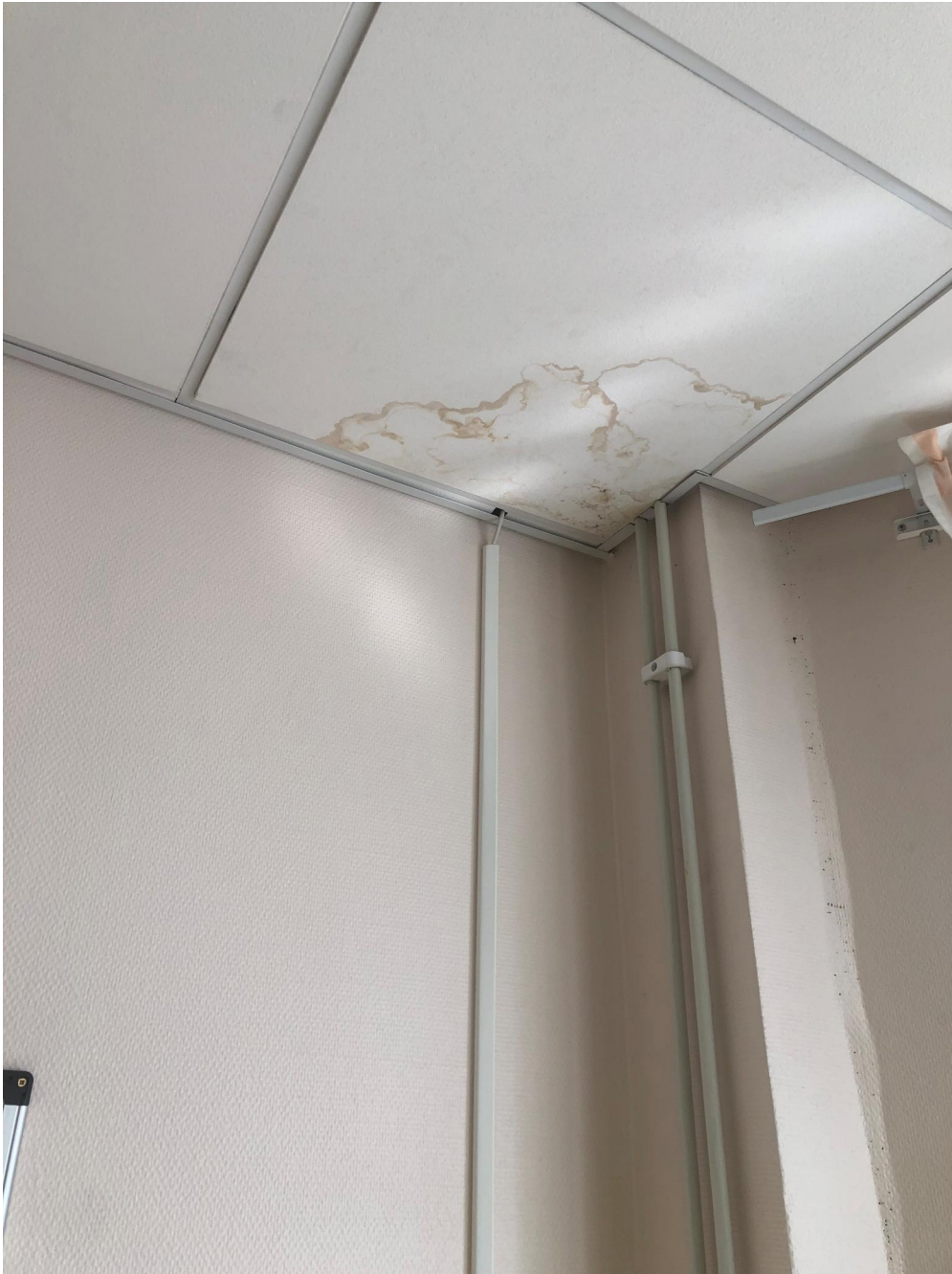
Gammal fuktskada på undertak i Kafferum
