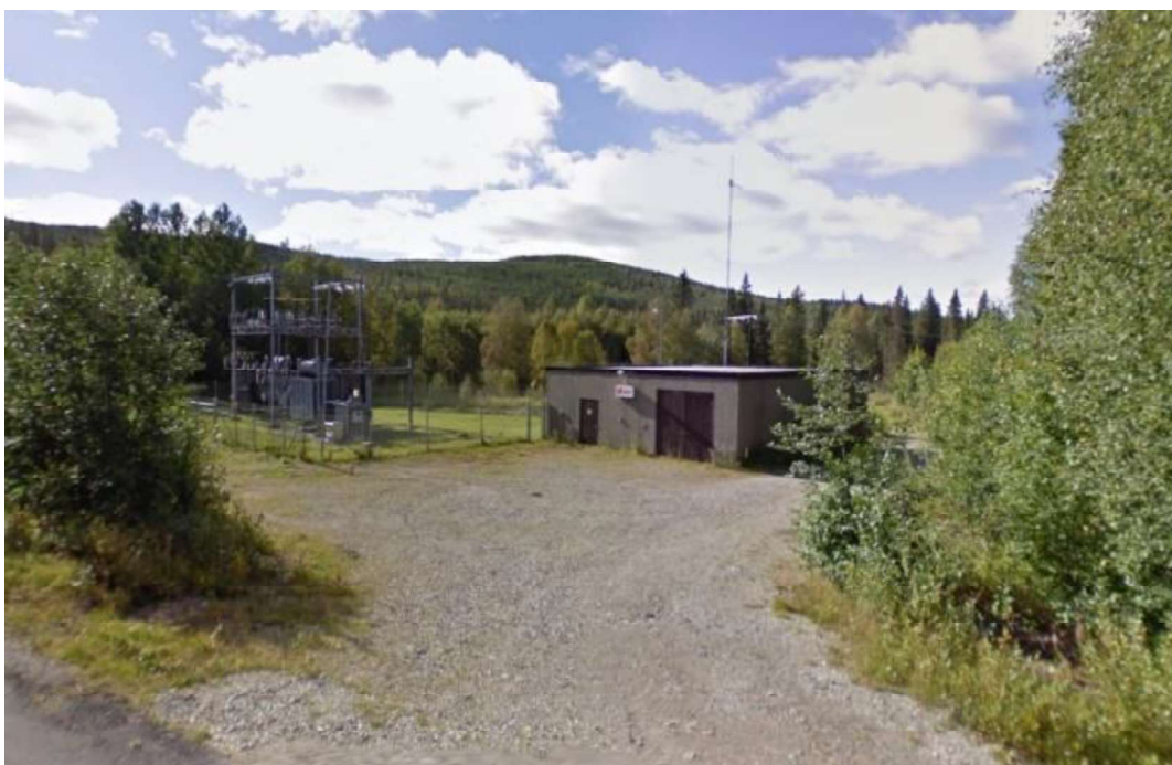
Figur 7. Befintligt ställverk som ska avvecklas.
