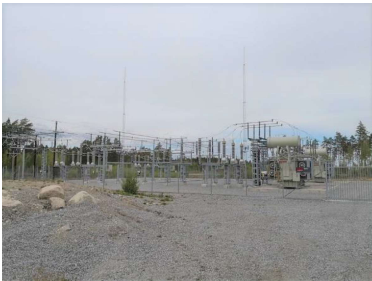
Figur 9. Exempel på ställverk.
